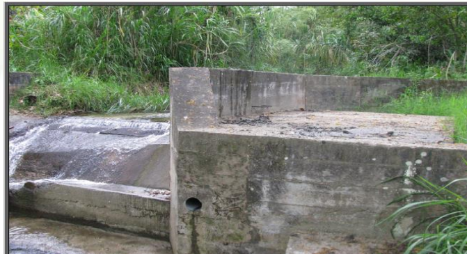
Imagen No. 1 Bocatoma
