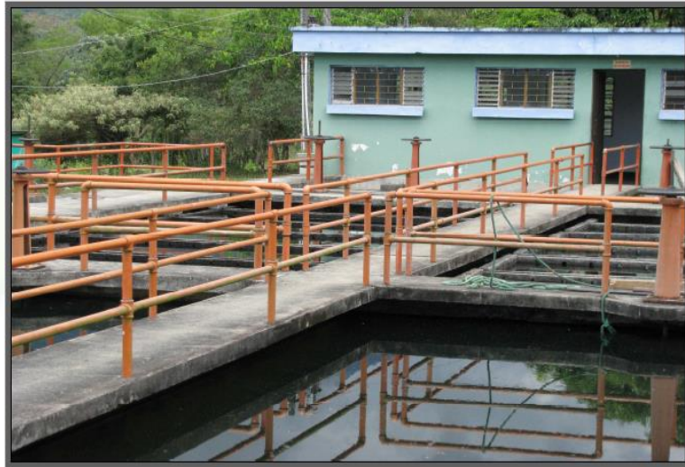
Imagen No. 5 Sedimentadores
