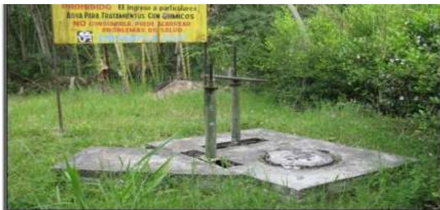
Figura 7 Tanque de succión
